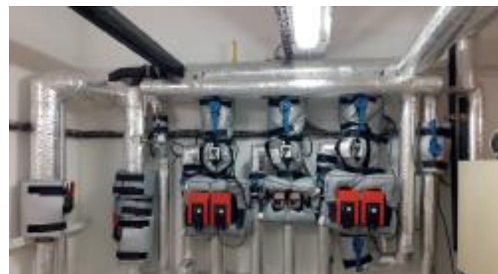
Le calorifugeage des conduits et pompes de chauffage des bâtiments visent à optimiser et réduire les consommations d'énergie.
