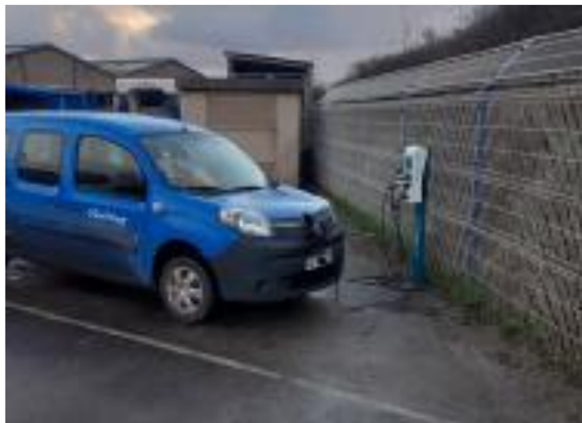
Installation de 2 nouvelles bornes de recharge électrique pour les véhicules du GPMD.
